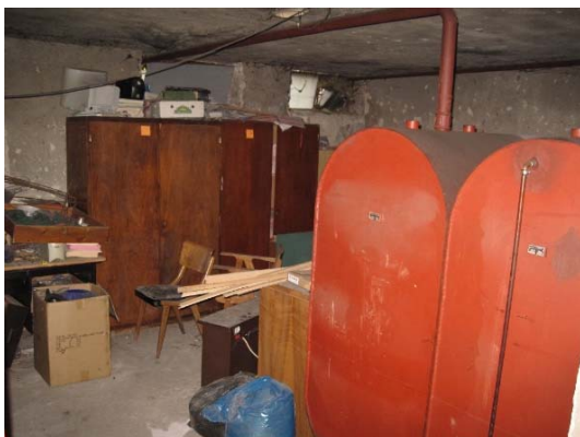
Slika 22: Stanje kotlovnice u Mrkonjić-Gradu
